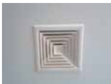
Air return / Air grill
